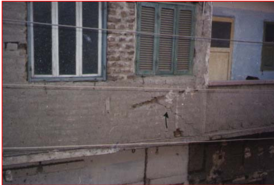
شروخ نتيجة تركيز
