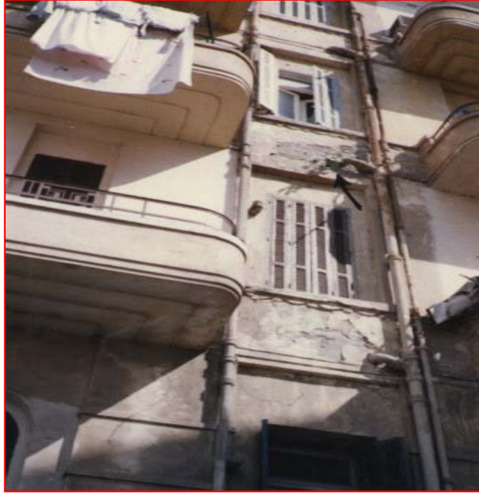
شرح نتيجة تسرب مياه الصرف
